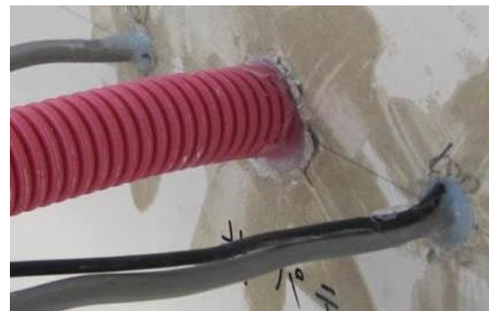
写真-6 ケーブル側状況 (非加熱側)
