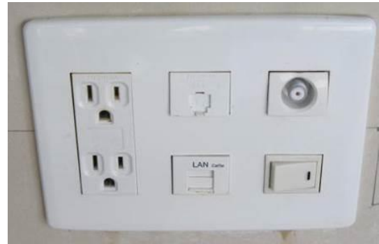
写真-4 コンセント側状況 (非加熱側)
