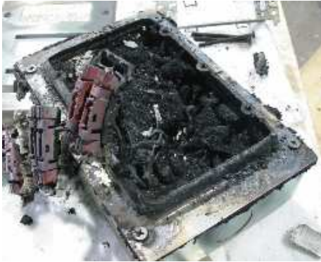
写真-2 加熱後膨張状況
