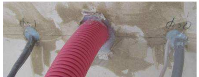
写真-7 60分加熱後ケーブル状況 (非加熱側)
