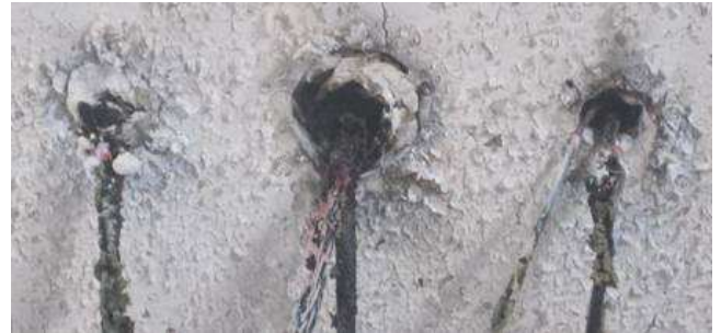
写真-11 ケーブル状況 (加熱側)
