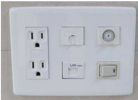
写真-4 加熱前コンセント状況 (非加熱側)
