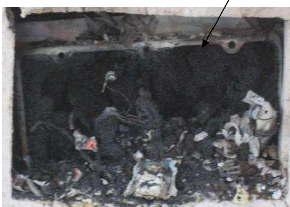
写真-10 コンセント状況 (加熱側)
