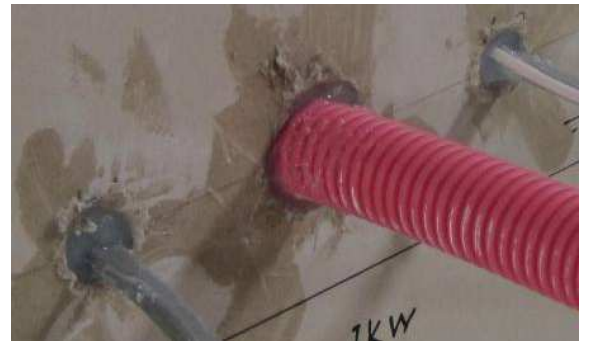
写真-5 加熱前ケーブル状況 (非加熱側)
