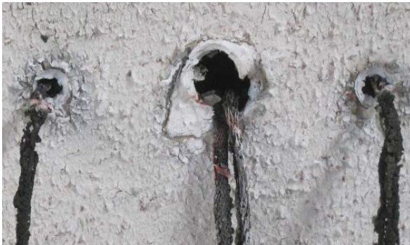
写真-3 60分加熱後ケーブル状況 (加熱側)
