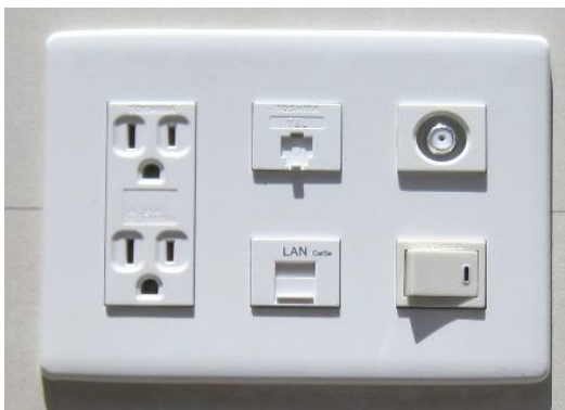
写真-1 加熱前コンセント状況
