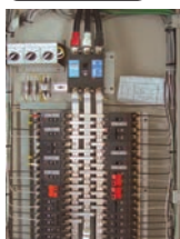
配電内部は危険!
